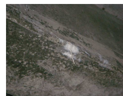
PCT桁の遊離石灰析出
