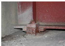
桁端部の腐食
