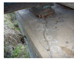
橋座部のせん断破壊(地震の影響)
