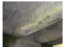
主桁の鉄筋露出
