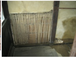
2階廊下壁破損部
