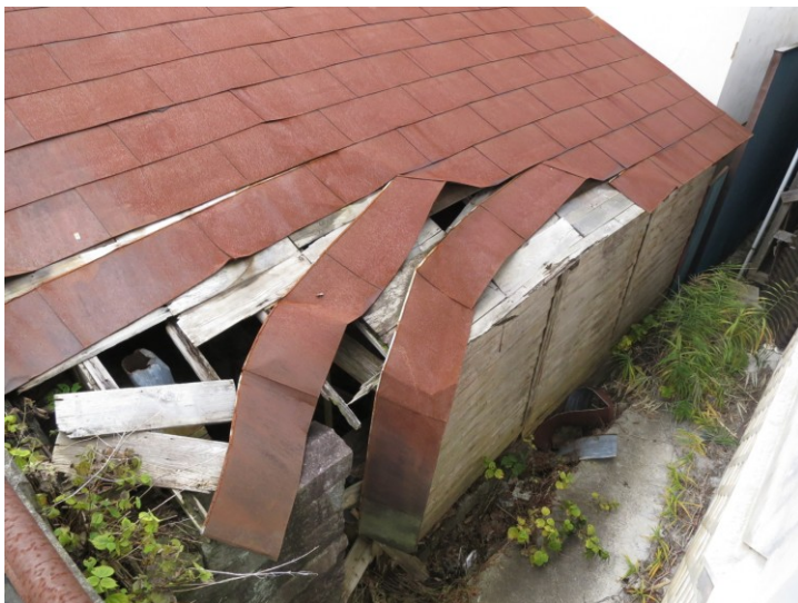
隣家側破損部
