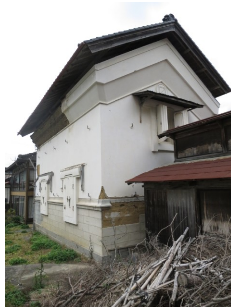
土蔵 1 損傷、越部
