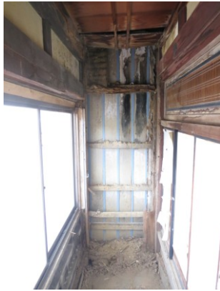
2階縁側壁破損部
