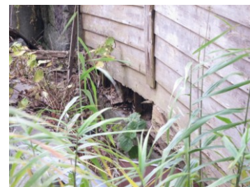
隣家側破損部
