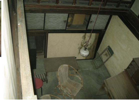
店舗続きお帳場 床腐朽部
