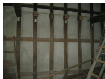
切断された梁
