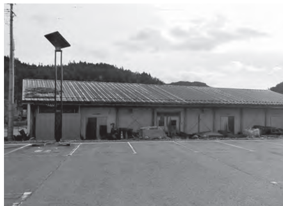
△ 役場の倉庫として利用されている建物には、保管スペースなどの課題がある
