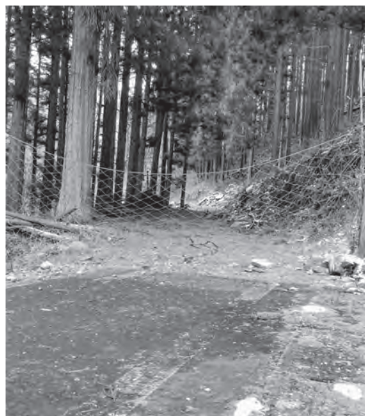
△ 地域住民によって維持管理が行われている火の土地区内の町道未舗装区間。舗装化を望む意見も寄せられた
