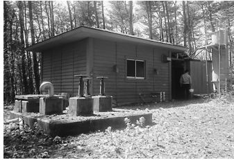
△ 森林公園内に設置されている水道膜ろ過施設の外観
