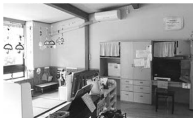
△ 保育園すべての保育室にエアコンが設置されました
