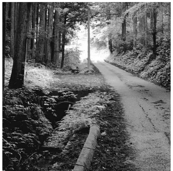
△ 道路幅が狭く、早期の改良が求められる向村大平線の梅ノ木地内
