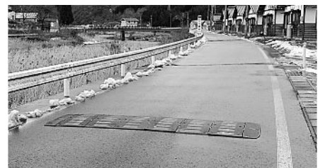
△取り外しの声が出たスピードハンブ(町営住宅川向団地の町道)
