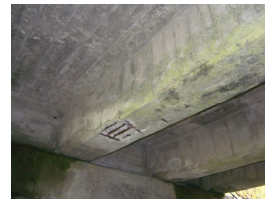
主桁の鉄筋露出
