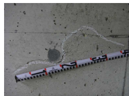
下部工の沈降ひびわれ
