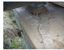
橋座部のせん断破壊(地震の影響)
