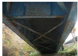
広範囲の腐食
