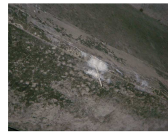
PCT桁の遊離石灰析出
