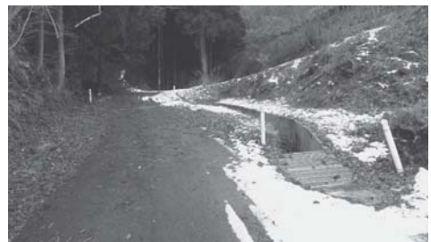
△町道高瀬小畑線の未改良区間
