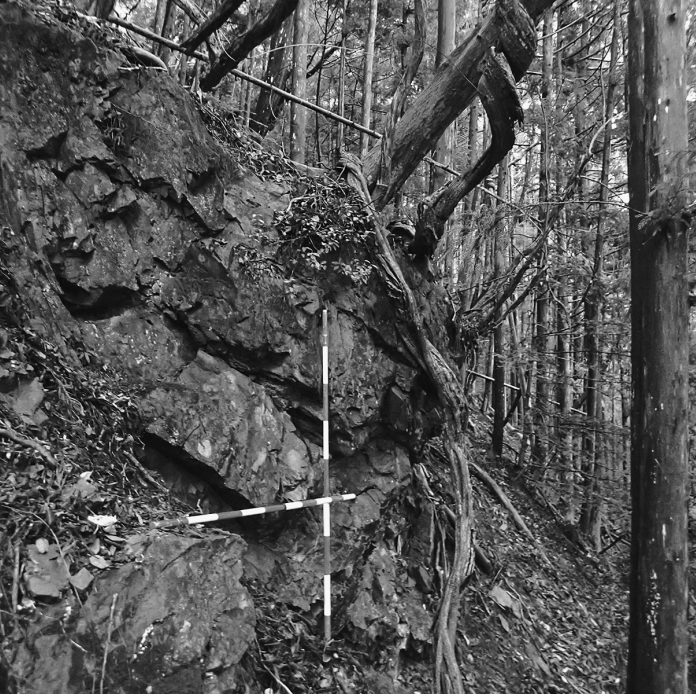
△ 浮き石の多い赤畑地区急傾斜地に防護柵
