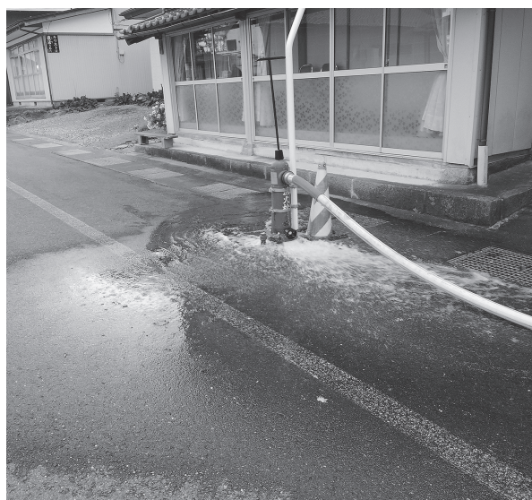
△ 目視点検のみならず、消防演習時や実際の接続点検も重要では…
