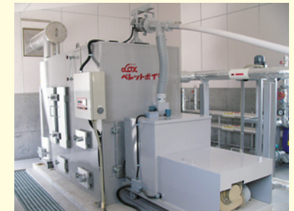
ペレットボイラー
