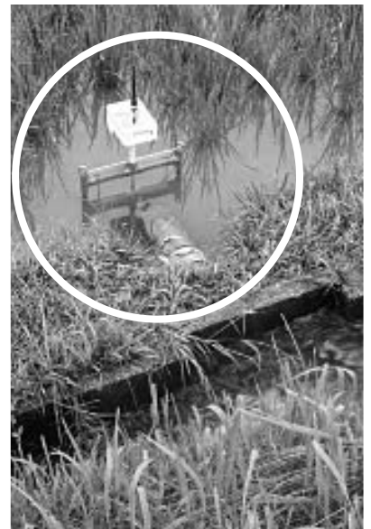
△ 町内での実装が期待される水位センサーと自動給水ゲート。
