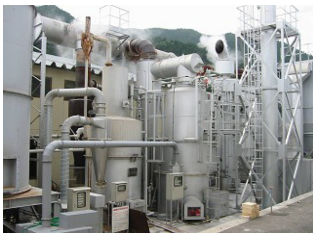
写真左：木屑炊きボイラー (三陸木材高次加工協同組合)
